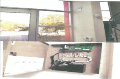
F3: Sistema de seguridad (alarma y sensores de movimiento)
