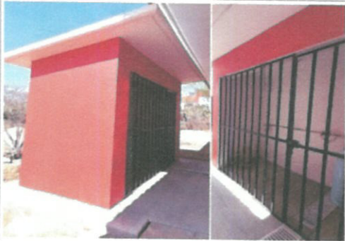
F1: INSTALACION DE GAS LAB, DE FARMACOLOGIA
