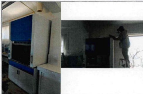
F4: CAMPANAS DE EXTRACCIÓN
